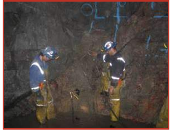
Rio Tinto, Mina de Diamante Diavik, Canadá Antes de las operaciones de excavación de minas subterráneas, se utilizaron métodos de inyección de cemento para rellenar fracturas saturadas de agua y reducir el potencial de infiltraciones de agua subterránea de alto volumen.
